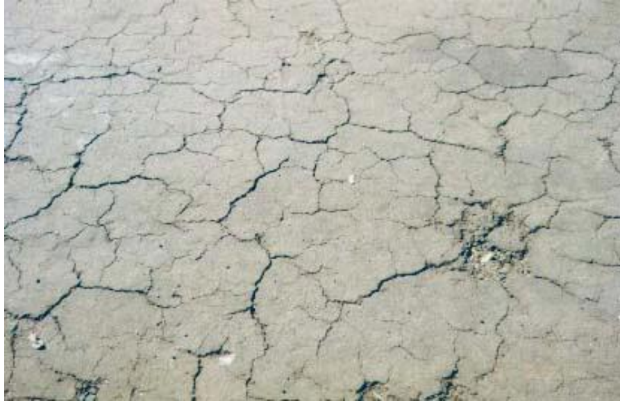
Figura 6 – Trinca em pavimento flexível
