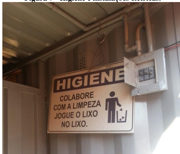
Figura 7 - Higiene e instalações elétricas.
