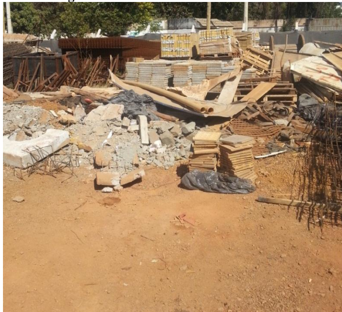
Figura 50 - Entulho e sobras de materiais.
