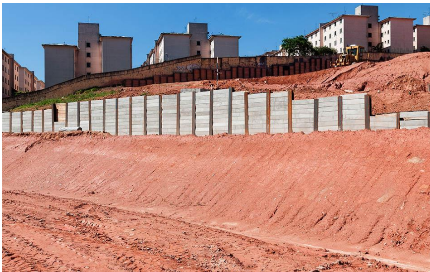
Imagem 3 - Estrutura de contenção provisória na obra Flex Osasco II em São Paulo no mês de dezembro de 2013
