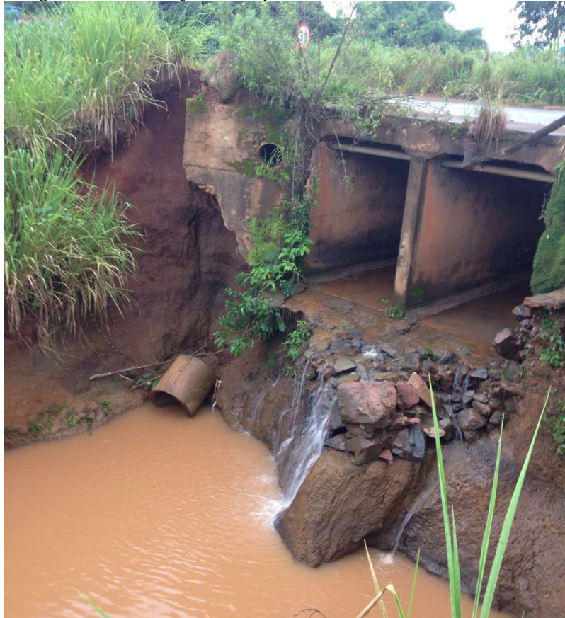
Imagem 22 - Erosão a jusante da ponte
