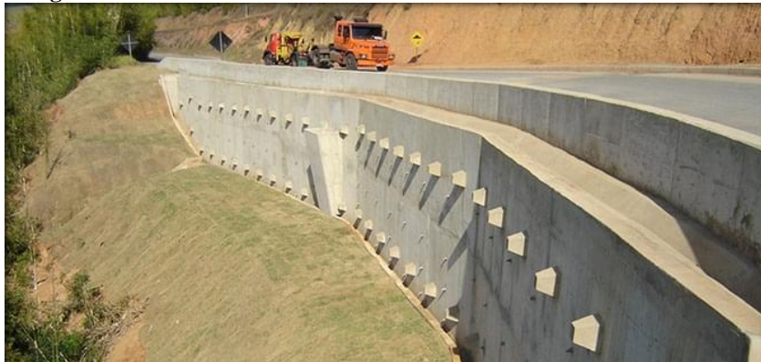
Imagem 8 - Cortina atirantada contendo encosta em estrada
