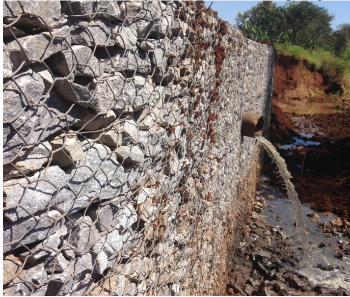
Imagem 60 - Fluxo de esgoto saindo no extravasador principal.
