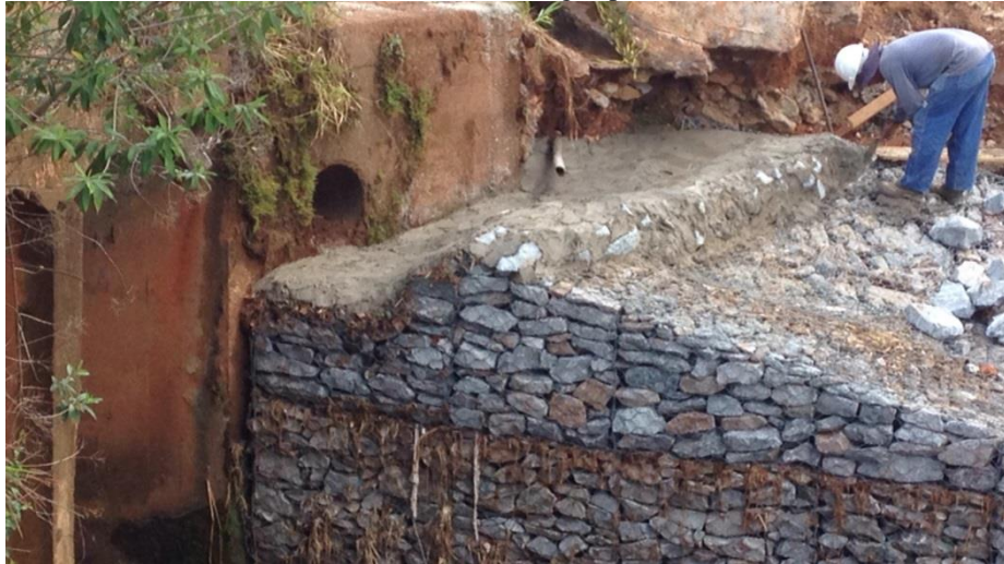
Imagem 59 - Estrutura de direcionamento de água pluvial.
