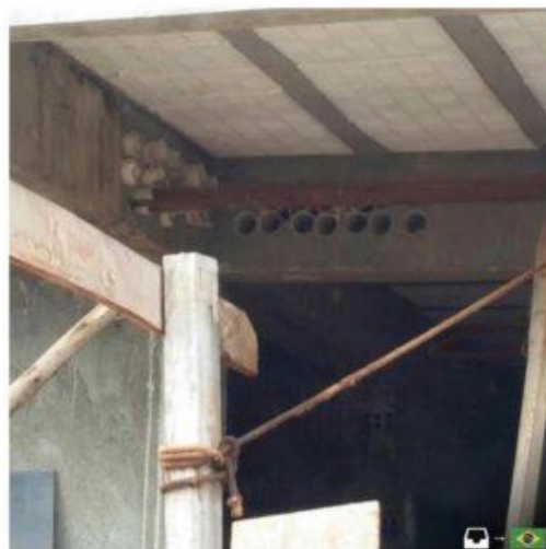
Figura 2 - Problemas causados durante a obra devido a incompatibilização de projetos
