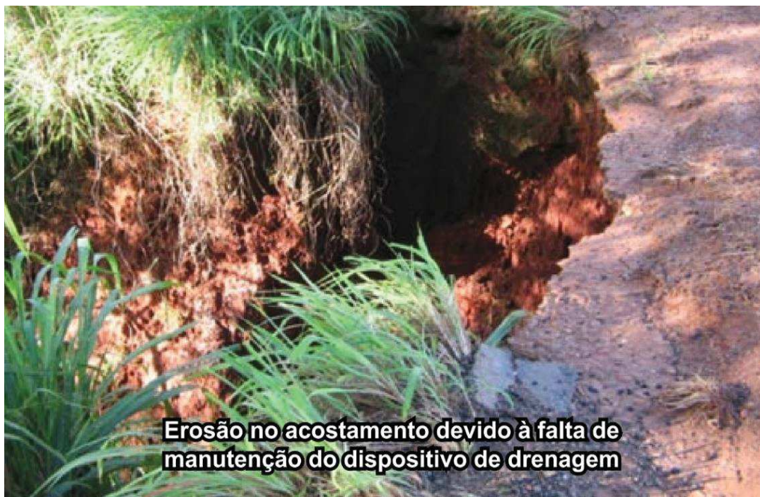
Figura 33 - Erosão no acostamento.
