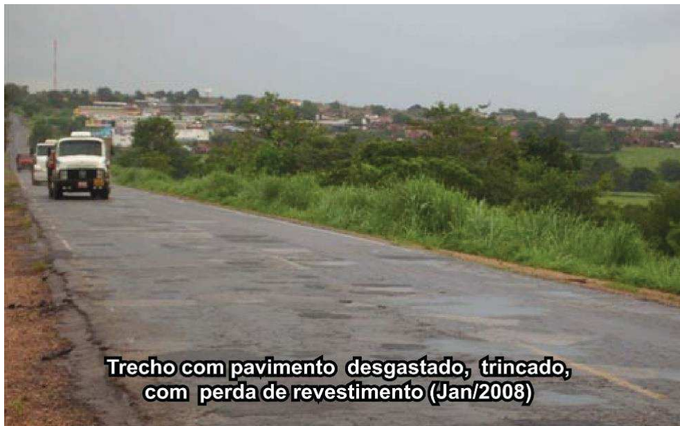
Figura 31 - Trecho com pavimento desgastado.
