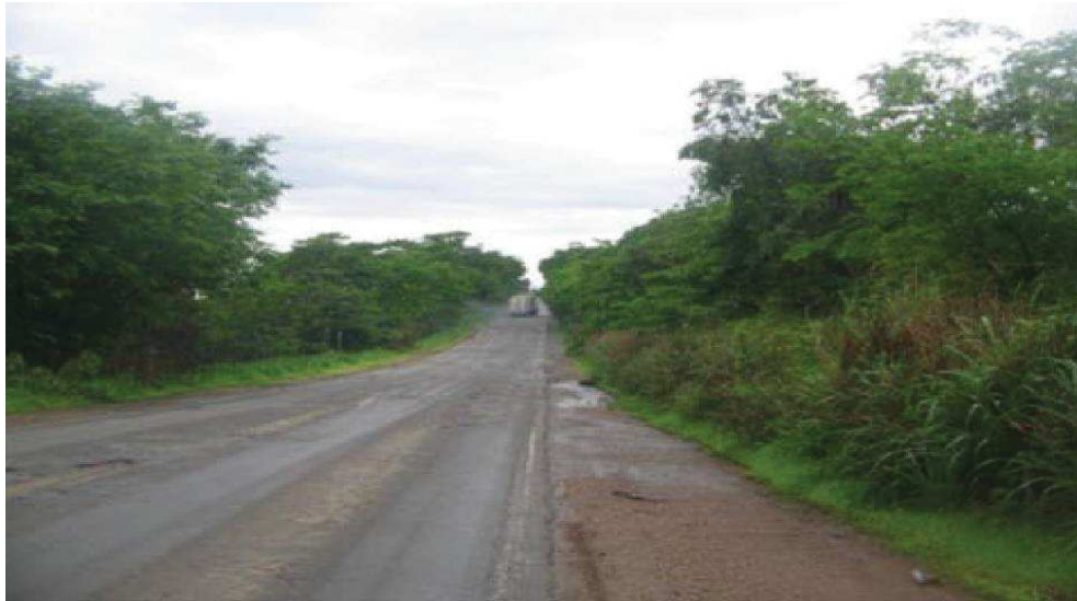
Figura 30 - Trecho com pavimento deteriorado.
