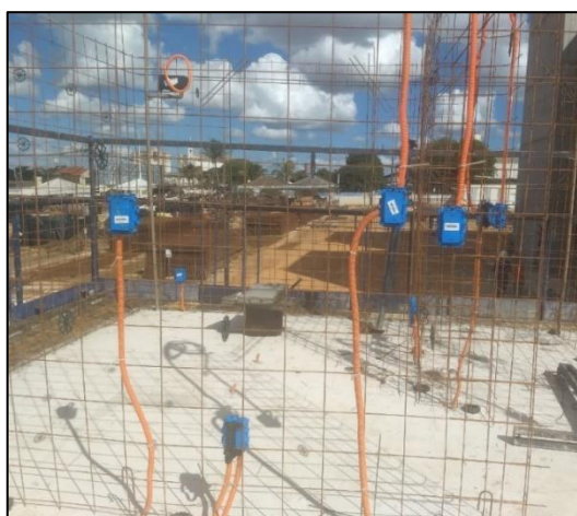
Figura 7 – Eletrodutos e caixas elétricas fixados nas telas.
