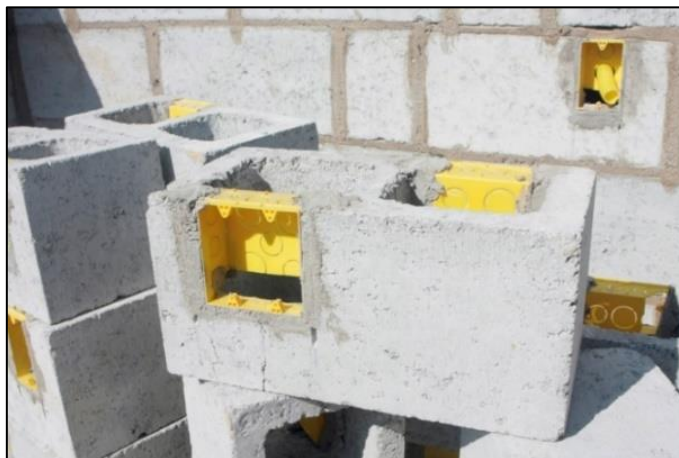
Figura 29 - Caixinhas de tomadas e interruptores chumbadas nos blocos.
