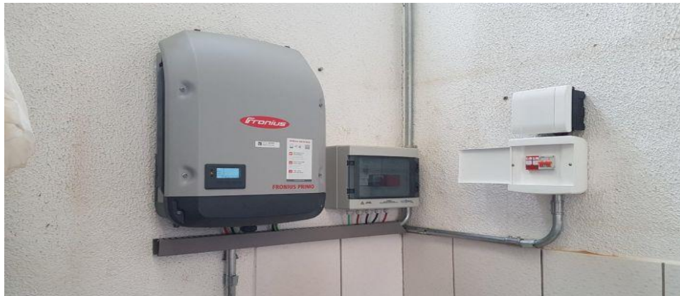
Figura 37 - Cabeamento passando pelo String Box e Inversor
