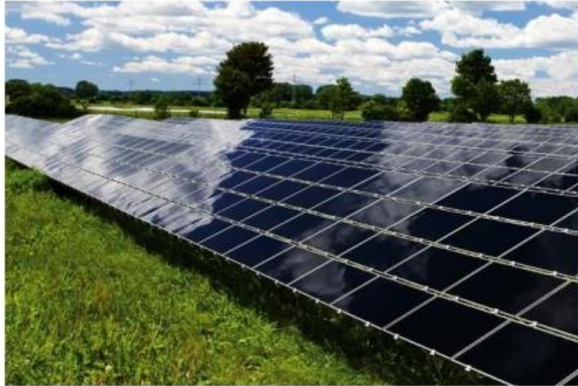
Figura 11 - Painel com módulos fotovoltaicos de filmes finos.
