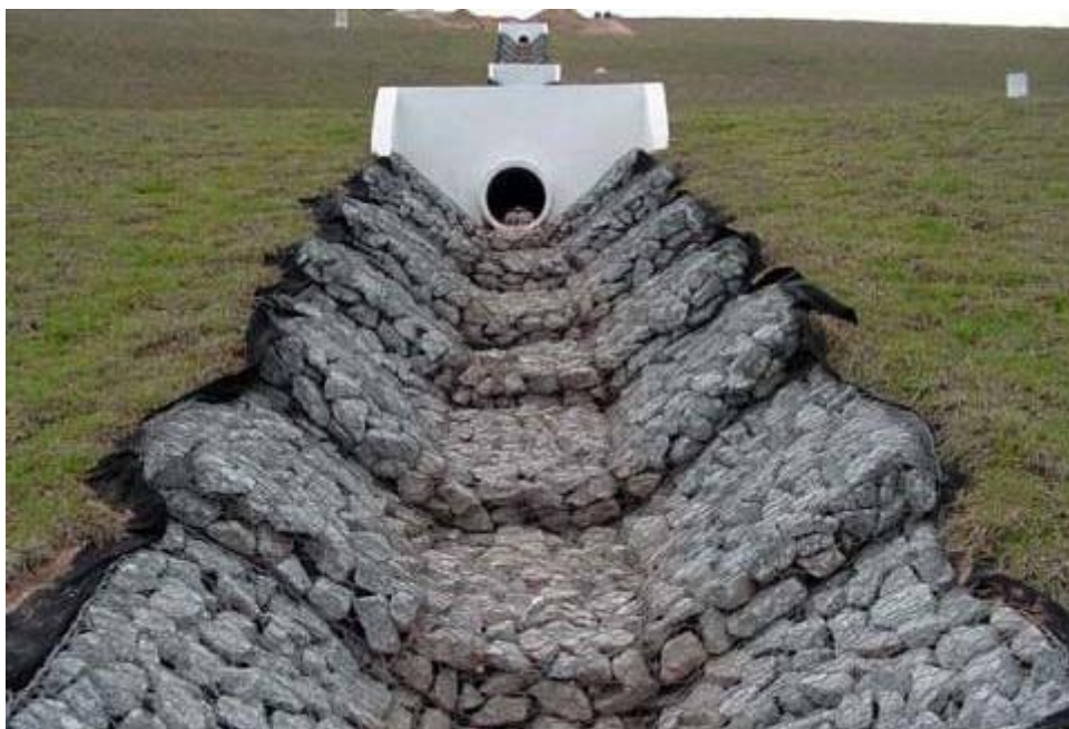
Figura 12 - Sistema de drenagem superficial do tipo colchão Reno
