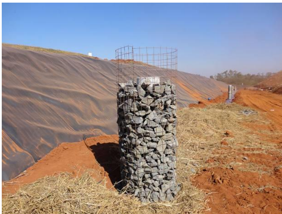
Figura 10 – Dreno de gás aterro sanitário de Jaboticabal - SP
