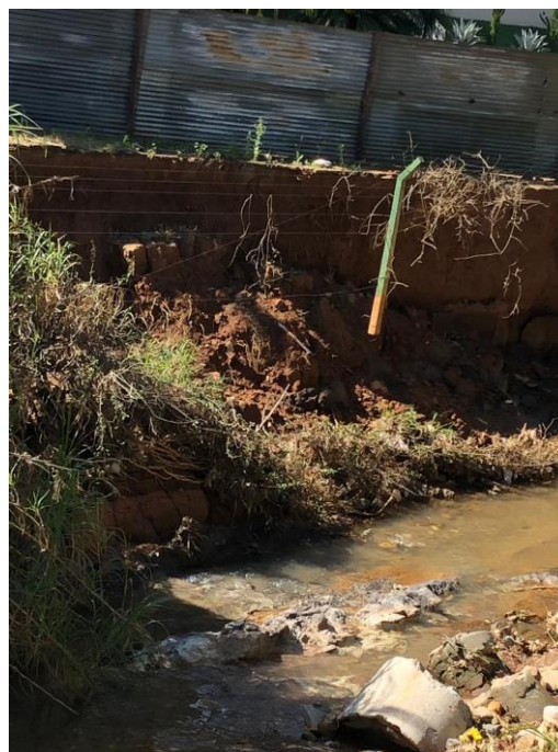
Figura 16 – Presença de erosão no córrego 2
