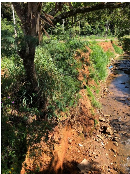
Figura 15 – Presença de erosão no córrego 1
