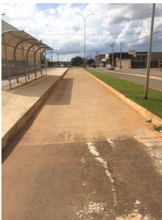
Figura 32 – Diferenciação na cor do pavimento.
