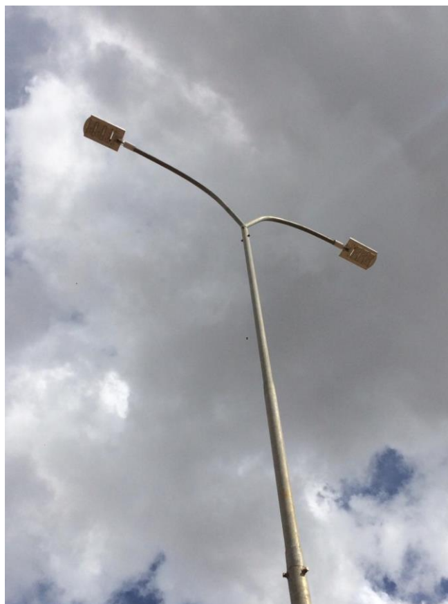
Figura 33 – Novo sistema de iluminação pública.
