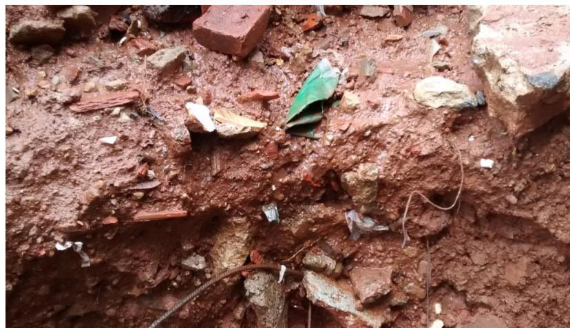
Figura 15- Foto da Erosão no Residencial Geovane Braga em 2015 com a presença de resíduos sólidos urbanos.
