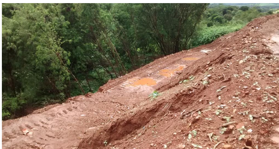
Figura 13- Foto da Erosão no Residencial Geovane Braga em 2015.
