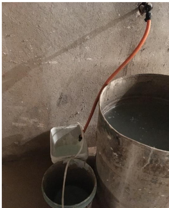
Figura 13- Abastecimento de água
