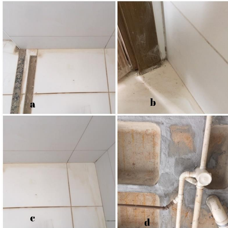
Figura 22 - Banheiro suíte cp1 (a) entrada do box (b) região atrás da porta (c) fundo do box (d) laje
