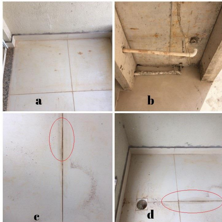
Figura 24 - Varanda cp1 (a) entrada da varanda (b) laje (c) detalhe próximo ao ralo (d) área próxima ao ralo
