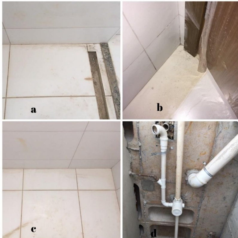
Figura 23 - Banheiro suíte cp2 (a) entrada do box (b) região atrás da porta (c) fundo do box (d) laje
