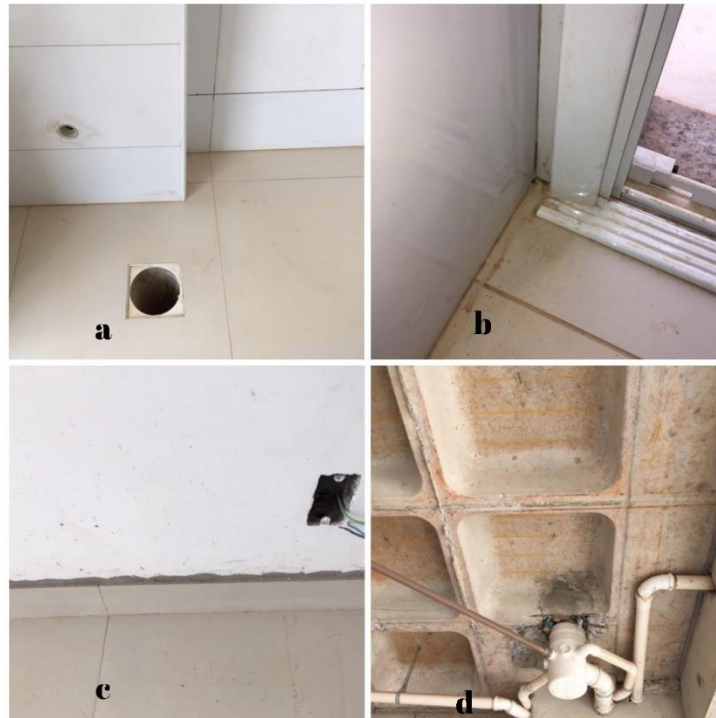
Figura 19 - Cozinha e lavanderia cp2 (a) cantos lavanderia (b) divisa lavanderia/sacada (c) face exterior do balcão da cozinha (d) face interior do balcão da cozinha
