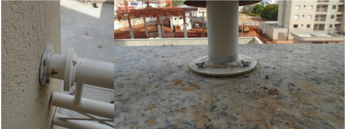
Figura 27 – Afrouxamento dos pontos de fixação do protótipo.
