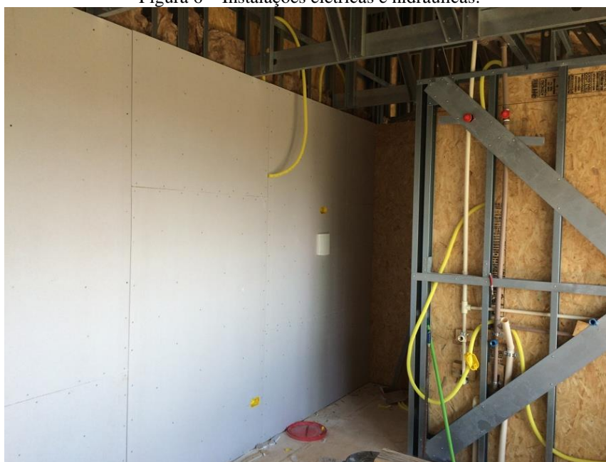
Figura 6 – Instalações elétricas e hidráulicas.
