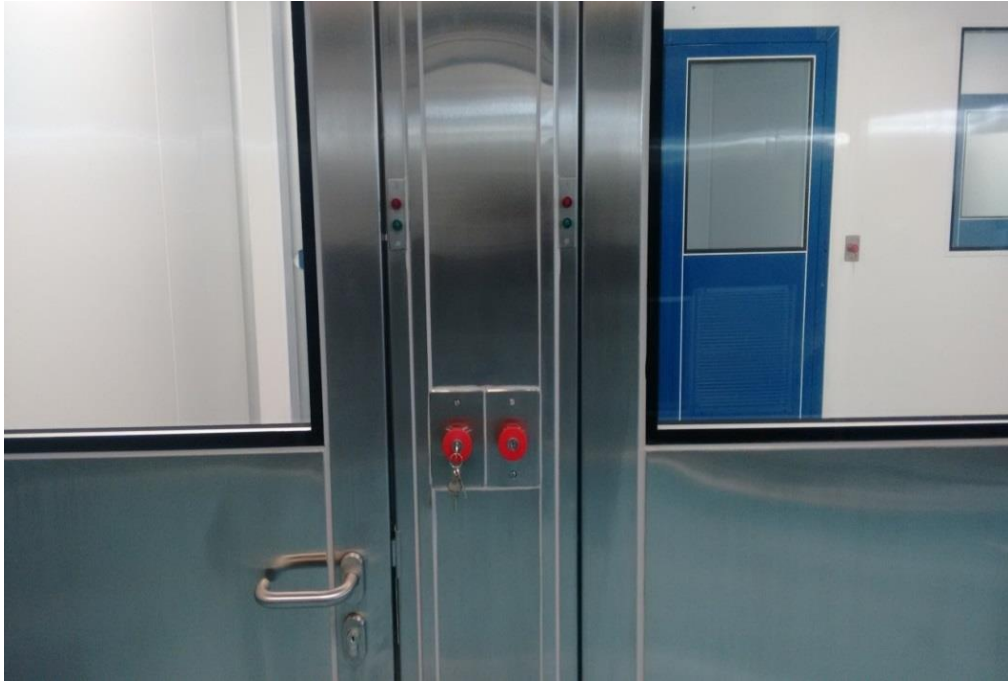
Figura 24 – Sistema de sinalização e botoeiras de emergência de uma antecâmara
