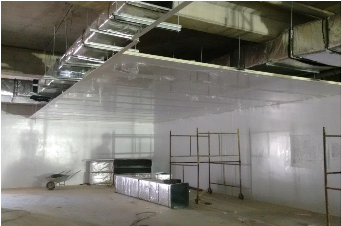
Figura 27 – Dutos de ar condicionado montados sobre o forro
