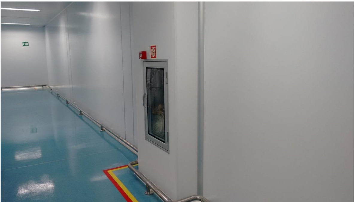
Figura 41 – Shaft em caixa de hidrante
