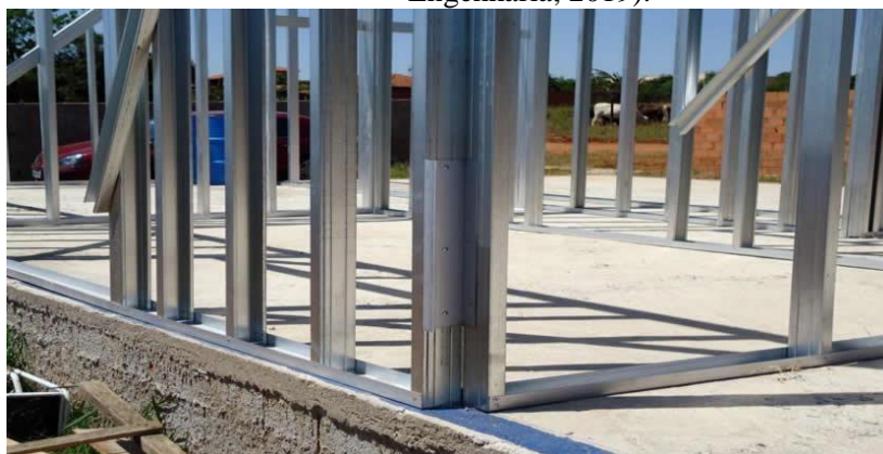
Figura 5. Estrutura em Steel Frame descarregando em fundação do tipo Radier (Solara Engenharia, 2019).
