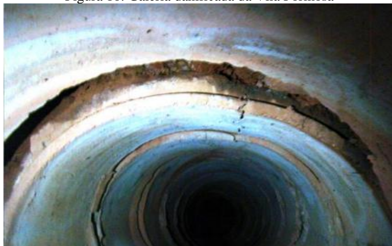
Figura 10: Galeria danificada da Vila Formosa
