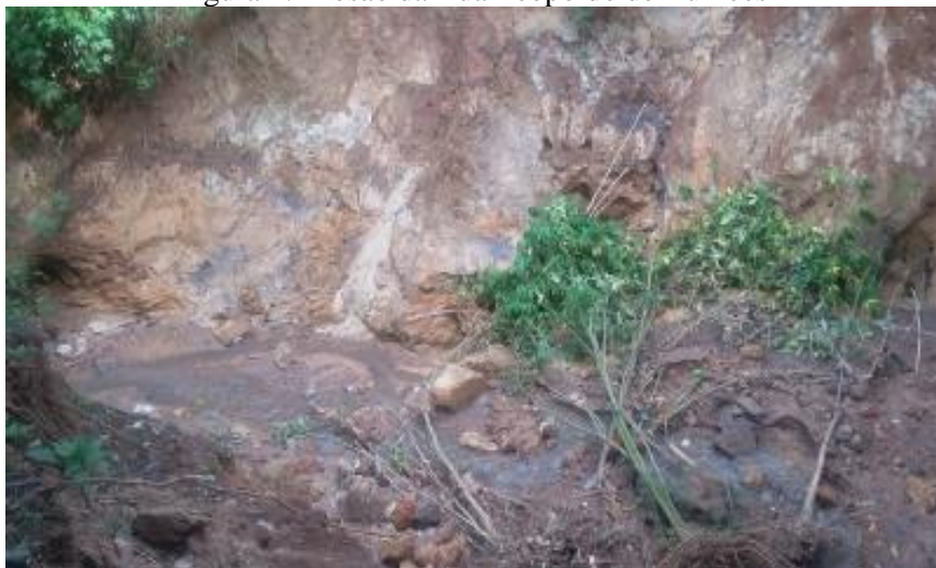
Figura 4: Erosão da Rua Leopoldo de Bulhões
