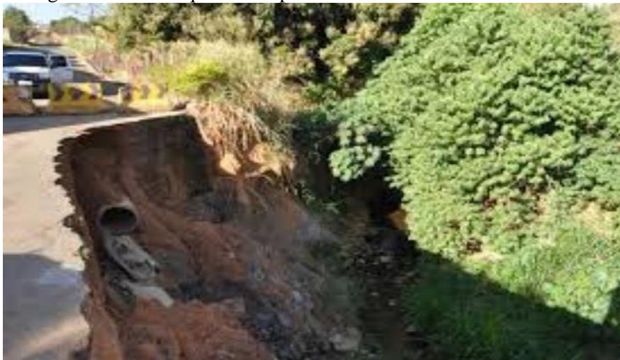
Figura 15: Erosão que corrompeu Avenida Federal da Vila Formosa
