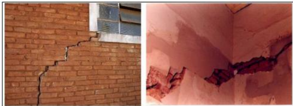
Figura 2: Avarias das edificações devido ao efeito do colapso
