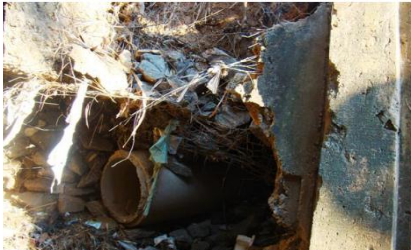
Figura 9: Galeria danificada da Vila Formosa
