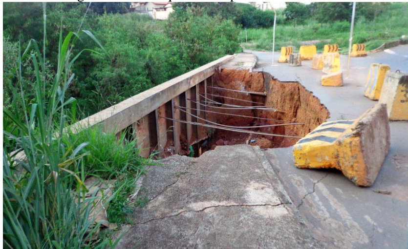
Figura 6: Erosão que corrompeu Avenida Federal
