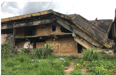
Imóvel destruído por mísseis - Kuito
