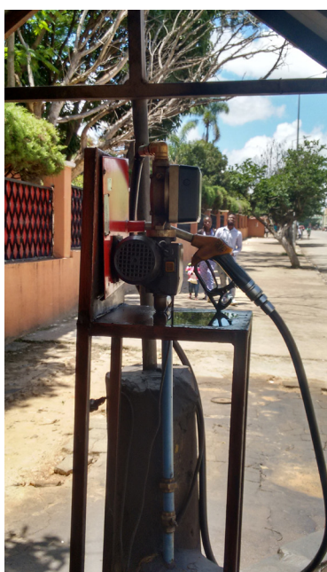
Bomba de combustível - Kuito
