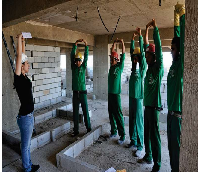
Figura 2.3 - Condições do ambiente de trabalho
