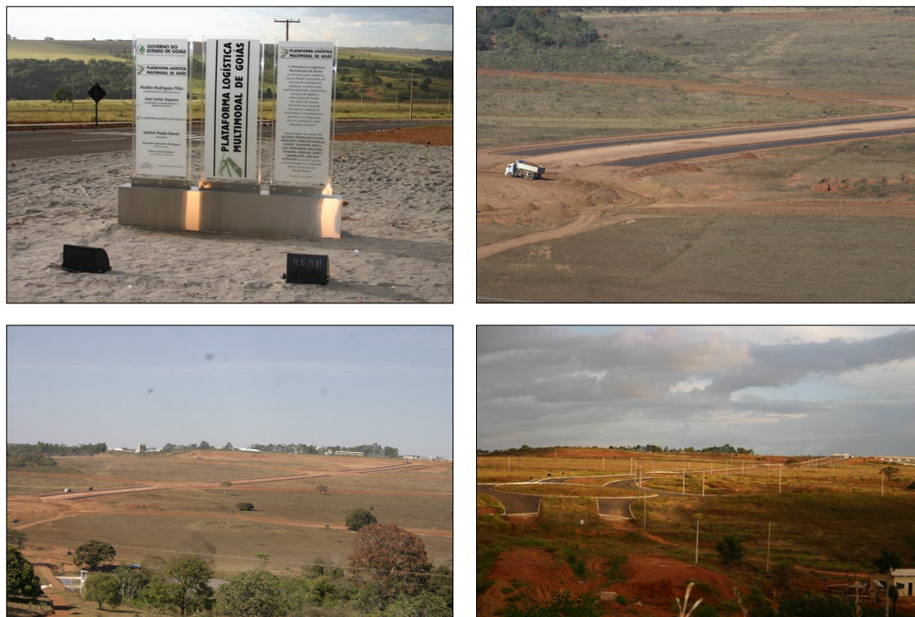
Figura 1.8: Implantação da 1ª etapa – Plataforma Logística Multimodal em Anápolis (GO). Fonte: SEPLAN (2008).
