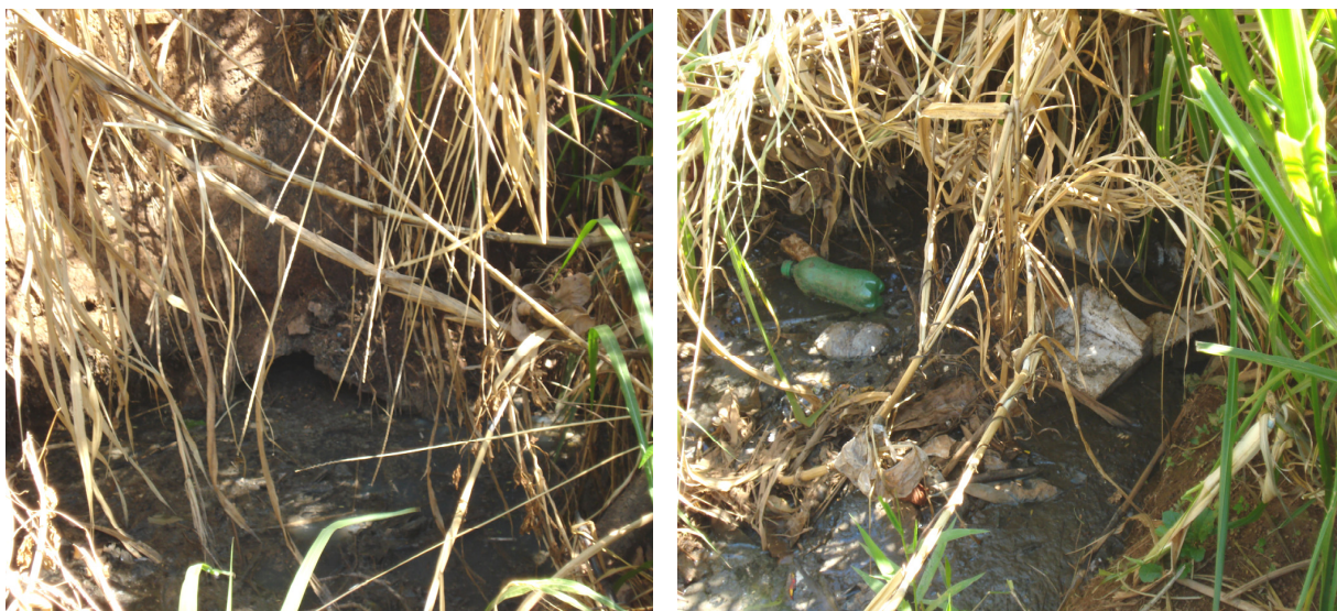
Figura 2.15: Emissário de esgoto despejado diretamente no Rio das Antas, região central de Anápolis (GO).
