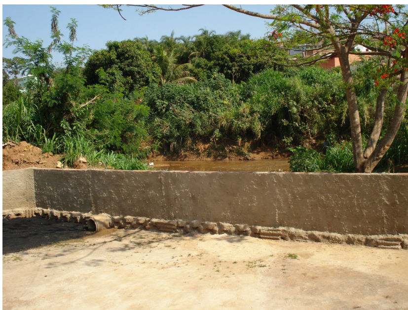
Figura 3.11: Muro construído no bairro Santa Maria de Nazaré para conter a água do Rio das Antas em épocas de enchente no município de Anápolis (GO), 2008.
