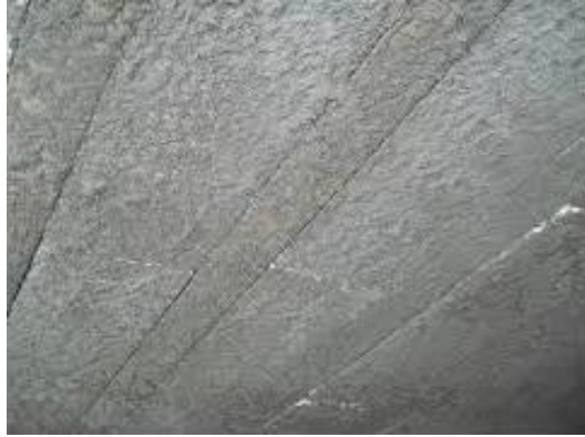
Figura 11 - Revestimento da Laje. Fonte: Comtrava (2016)
