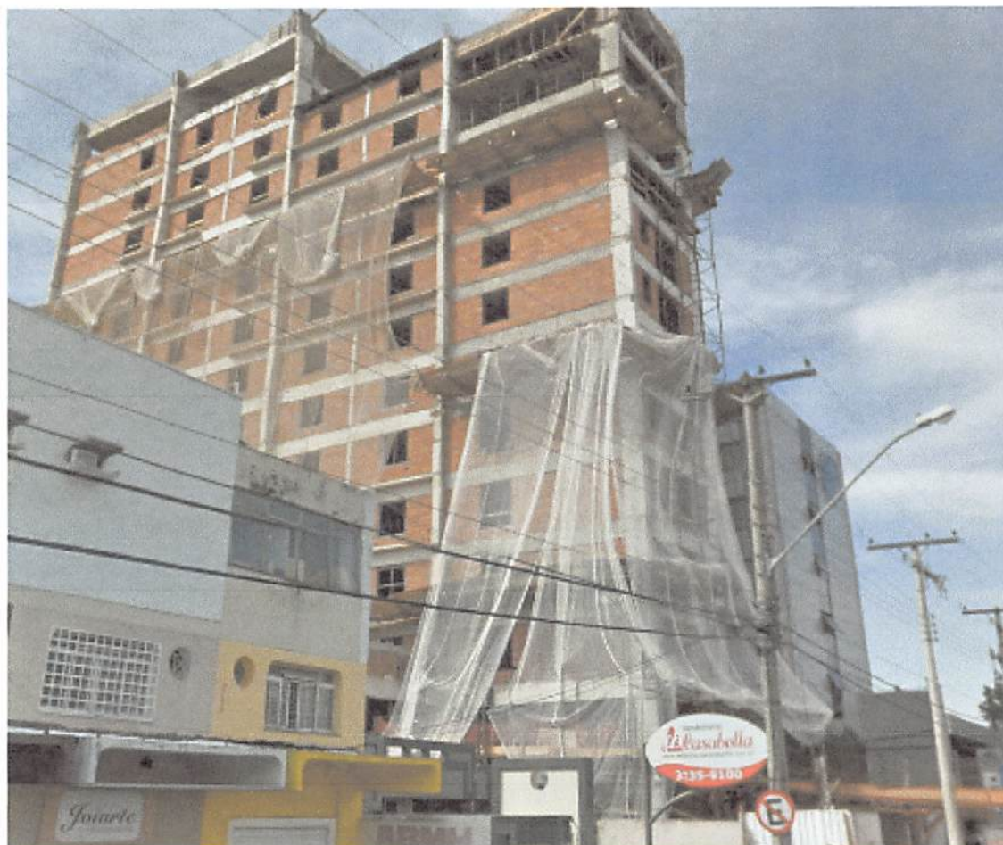
Figura 2.40 - Edifício Blue Tree: Interferência de Construções Vizinhas
