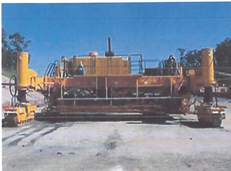
Figura 2.7 - Texturizadora de pavimento de concreto
