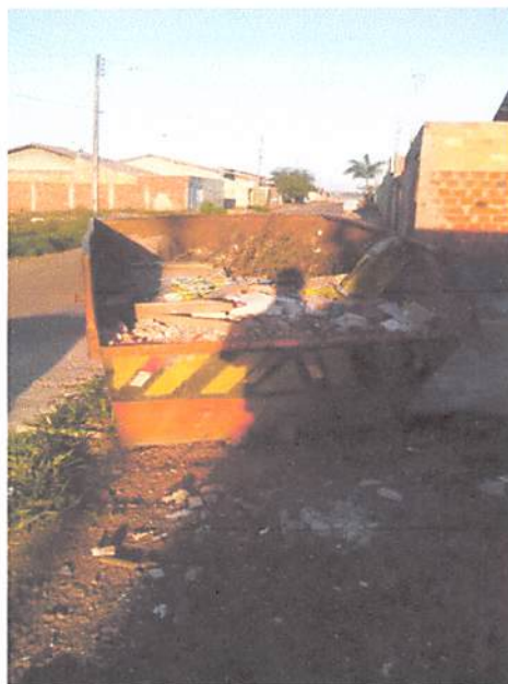
Figura1.4 - RCC contaminados com resíduos domésticos.
