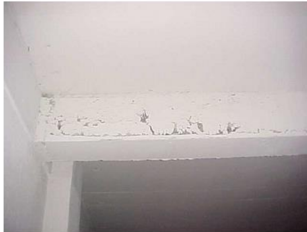
Figura 25 - Segregação do concreto armado
