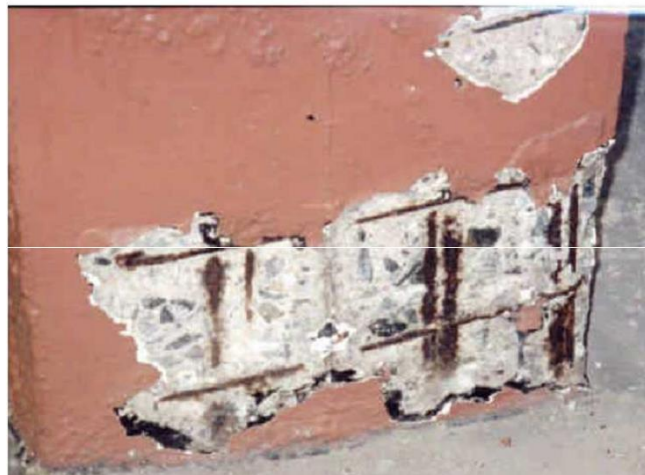
Figura 24 - Corrosão das armaduras
