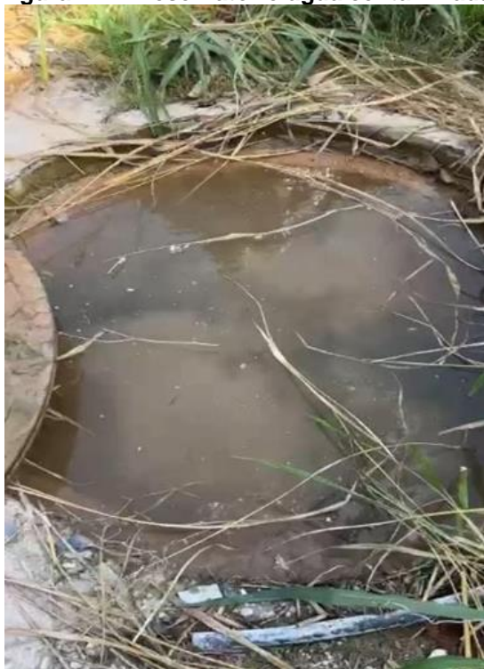
Figura 2 – 1º reservatório água contaminada
