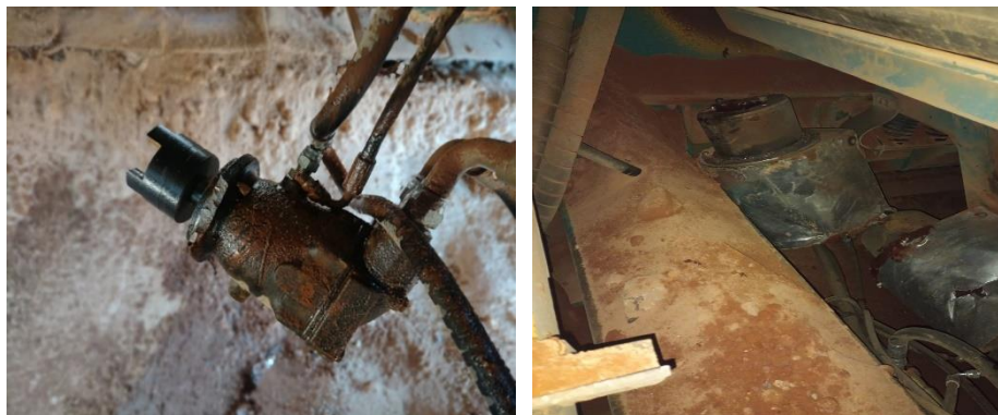
Figura 4: Motores Hidráulicos danificados
