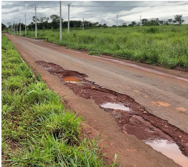
Figura 3 - Formação de erosão no pavimento
