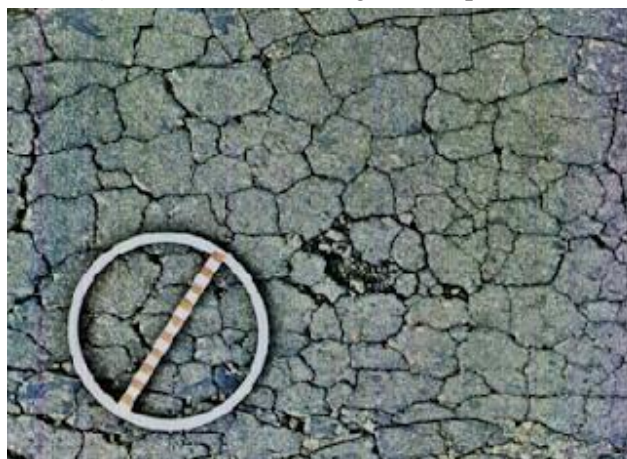
Figura 4 - Trinca interligada – Tipo Jacaré
