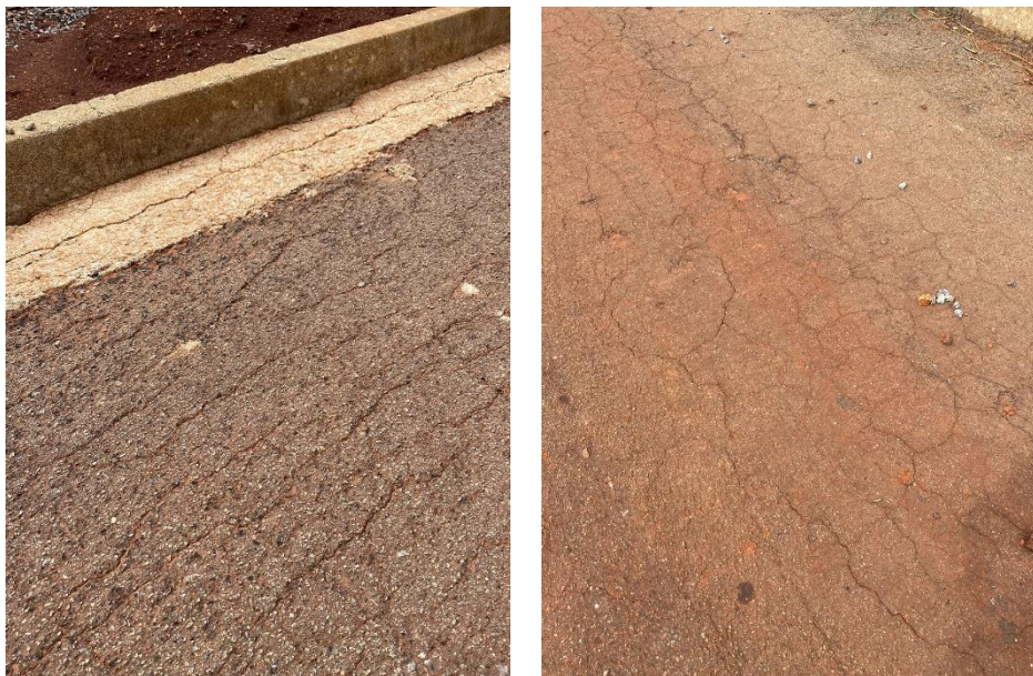
Figura 9 – Fissuras e Trincas no pavimento em dois locais distintos, representados em (a) e (b)
