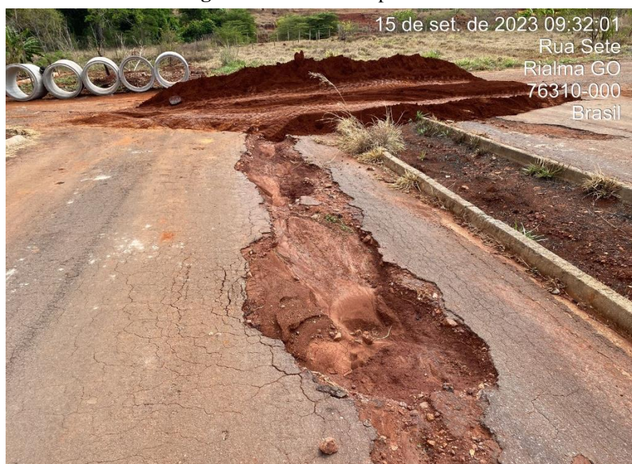
Figura 8 - Abertura no pavimento
