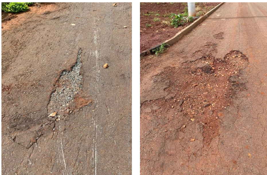
Figura 10 – Panelas e Buracos no pavimento em dois locais distintos, representados em (a) e (b)
