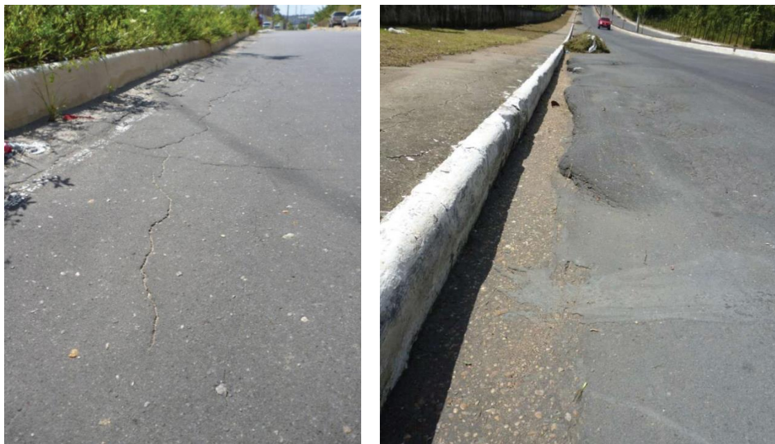
Figura 2 - Trinca longitudinal (a) e Escorregamento (b)
