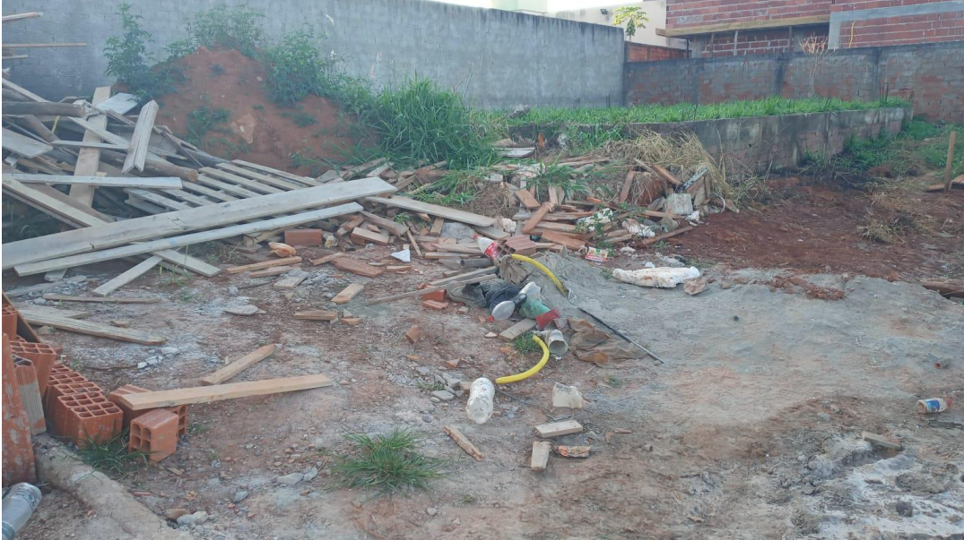
Figura 09 – Descarte indevido de resíduos de construção civil
