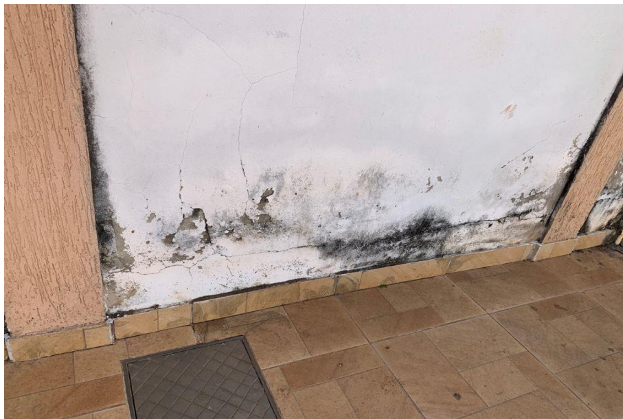
Figura 21– Infiltrações e rachaduras na fachada
