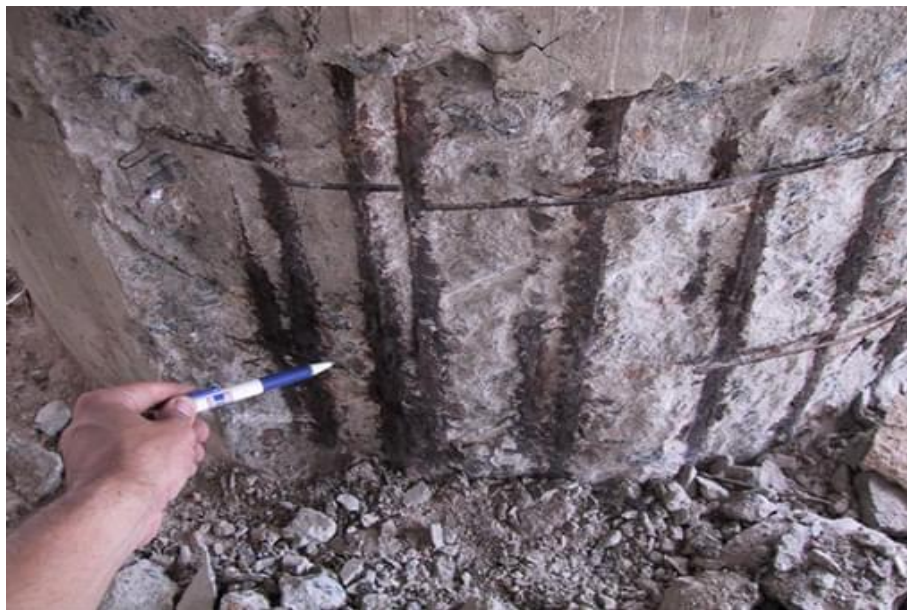
Figura 4 – Caso de corrosão do concreto
