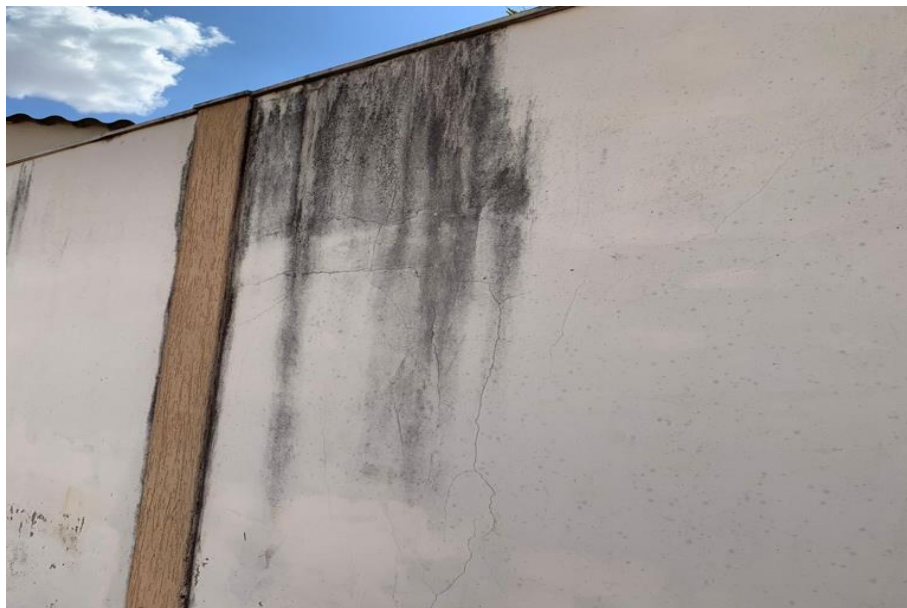
Figura 20– Parede externa com pingadeira mal instalada
