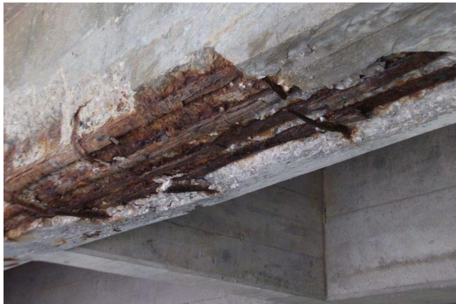
Figura 8 – Caso de oxidação das armaduras
