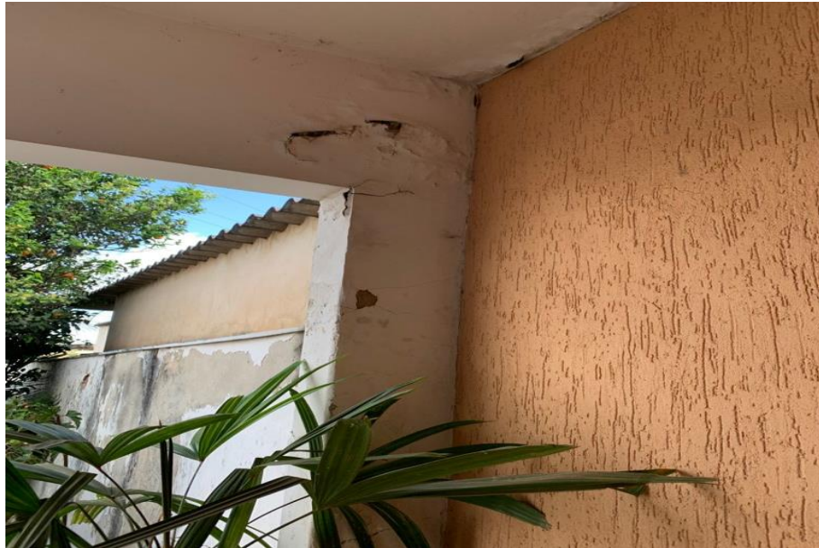
Figura 22– Infiltrações na laje
