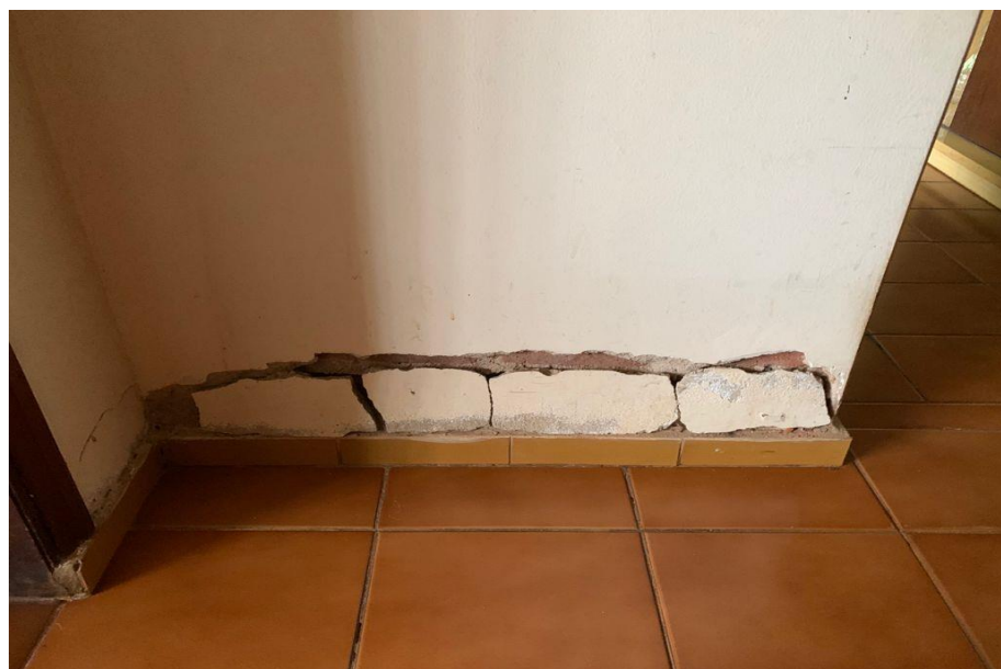
Figura 24– Ausência do chapisco devido a infiltração
