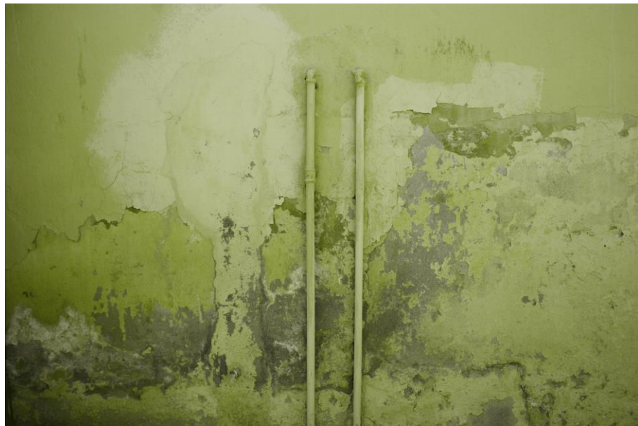
Figura 13 – Caso de bolor na parede
