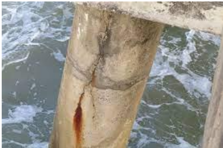
Figura 12 – Caso de despassivação em obra marítima
