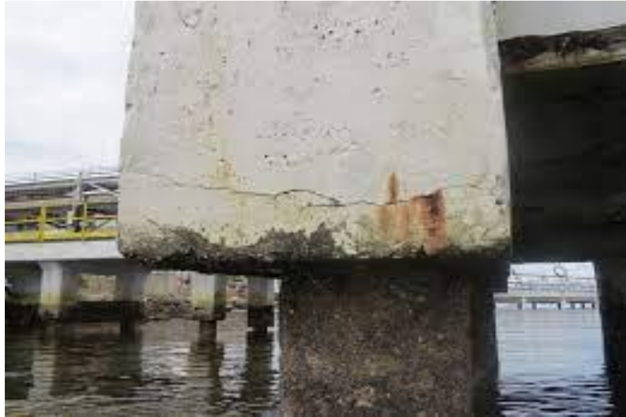
Figura 11 – Caso de despassivação por cloretos
