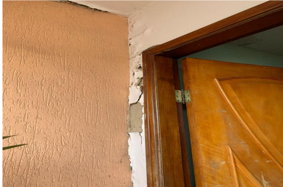
Figura 23– Infiltrações a má dosagem do reboco
