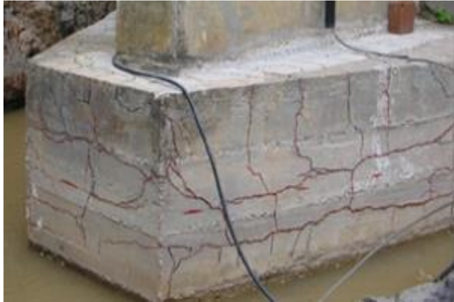
Figura 6 – Caso de expansão do concreto
