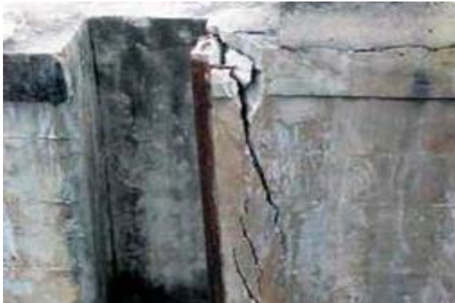
Figura 7 – Caso de expansão e descolamento da estrutura
