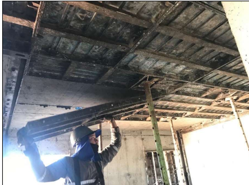
Figura 36 - Desforma da edificação
