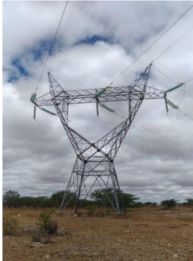
Figura 8: Torre de Ancoragem
