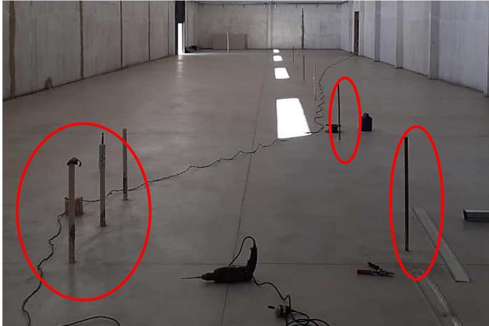
Figura 14 – Pontos de tubulação.
