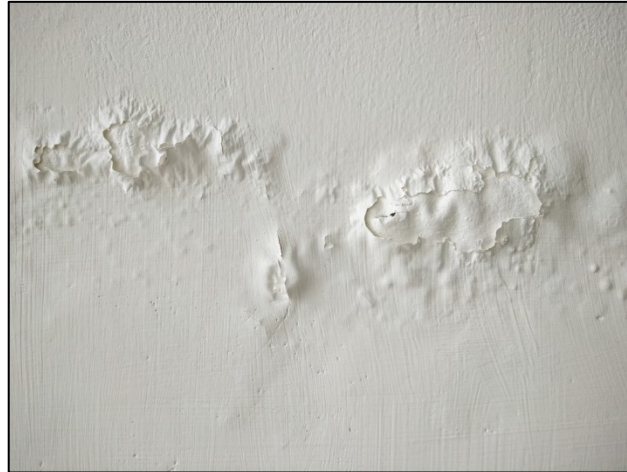
Figura 13 - Pontos estourados na pintura da parede
