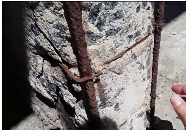
Figura 8 - Corrosão de armaduras dos pilares
