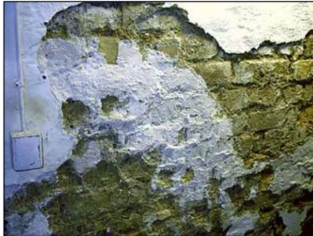
Figura 10 - Deslocamento de revestimento causado por criptoflorescência em parede
