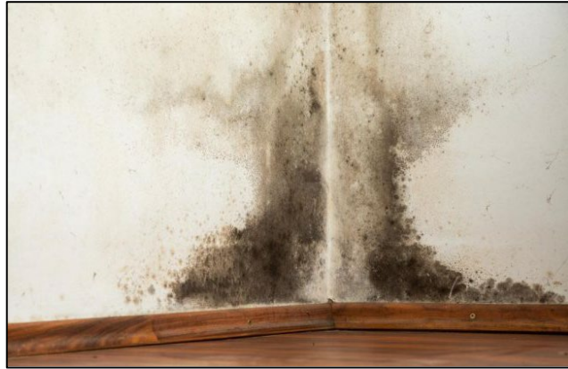
Figura 7 - Mancha escura de mofo na base de parede
