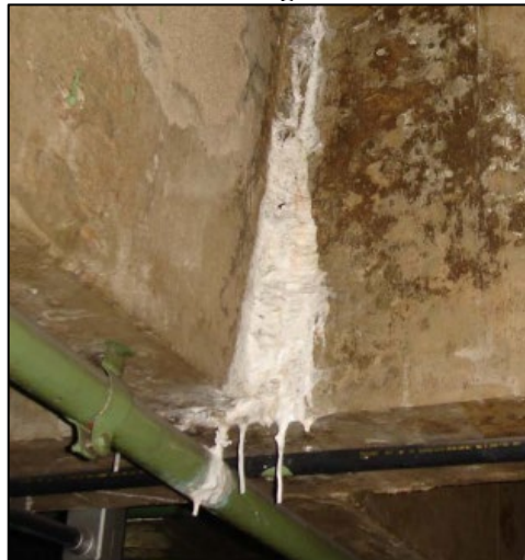
Figura 9 - Eflorescência em um encontro de vigas
