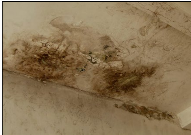
Figura 11 - Mancha no teto causada por infiltrações
