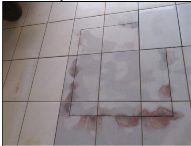
Figura 12 - Manchas no revestimento de piso causado pela ação da umidade
