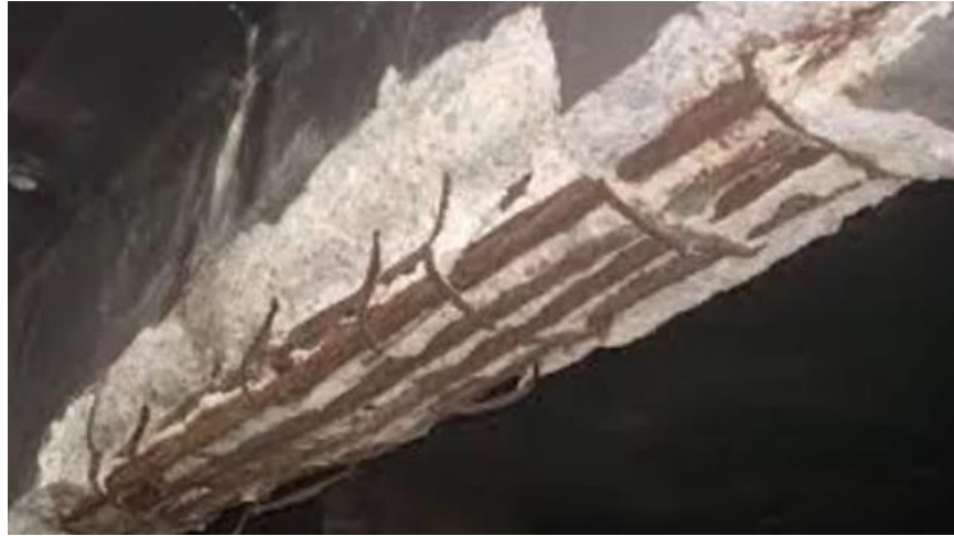
Figura 04 - Corrosão da armadura
