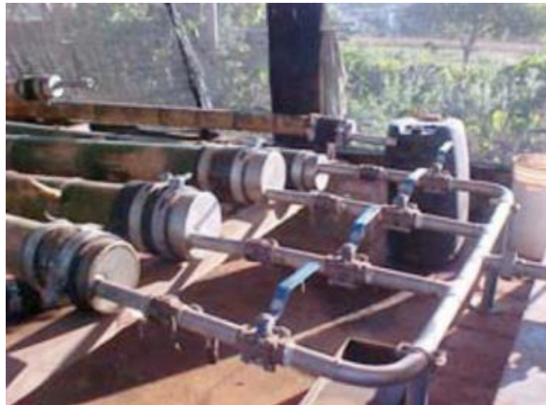
Figura 19 – Detalhe das conexões do equipamento de Broucherie Modificado
