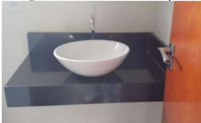
Figura 31 – Pia de mármore com cuba de apoio
