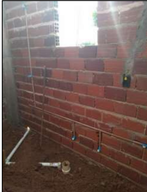
Figura 25 – Tubulação de água fria embutida na alvenaria
