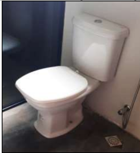
Figura 30 – Vaso de descarga com caixa acoplada
