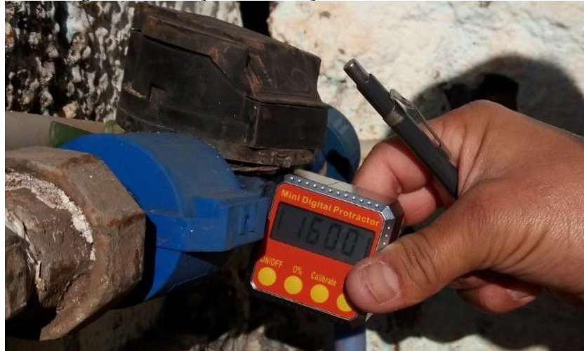
Figura 38 - Medição de inclinação Lateral de Hidrômetros
