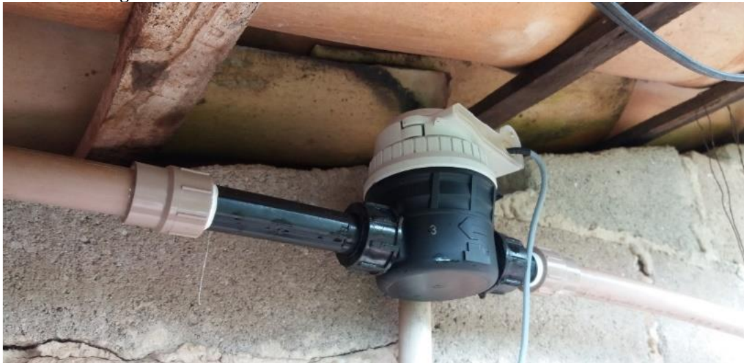
Figura 29 - Hidrômetro Volumétrico teste de vazão classe C instalado
