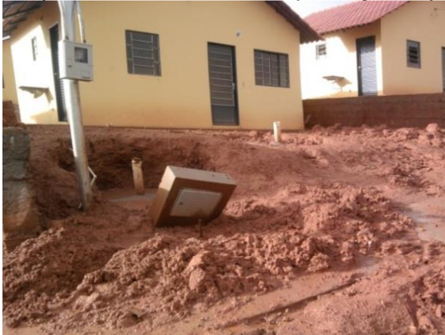
Ilustração 35– As fossas transbordaram nas calçadas sem pavimentação
