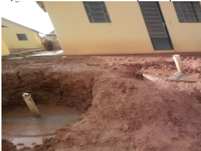
Ilustração 34– As fossas transbordaram nas calçadas sem pavimentação.
