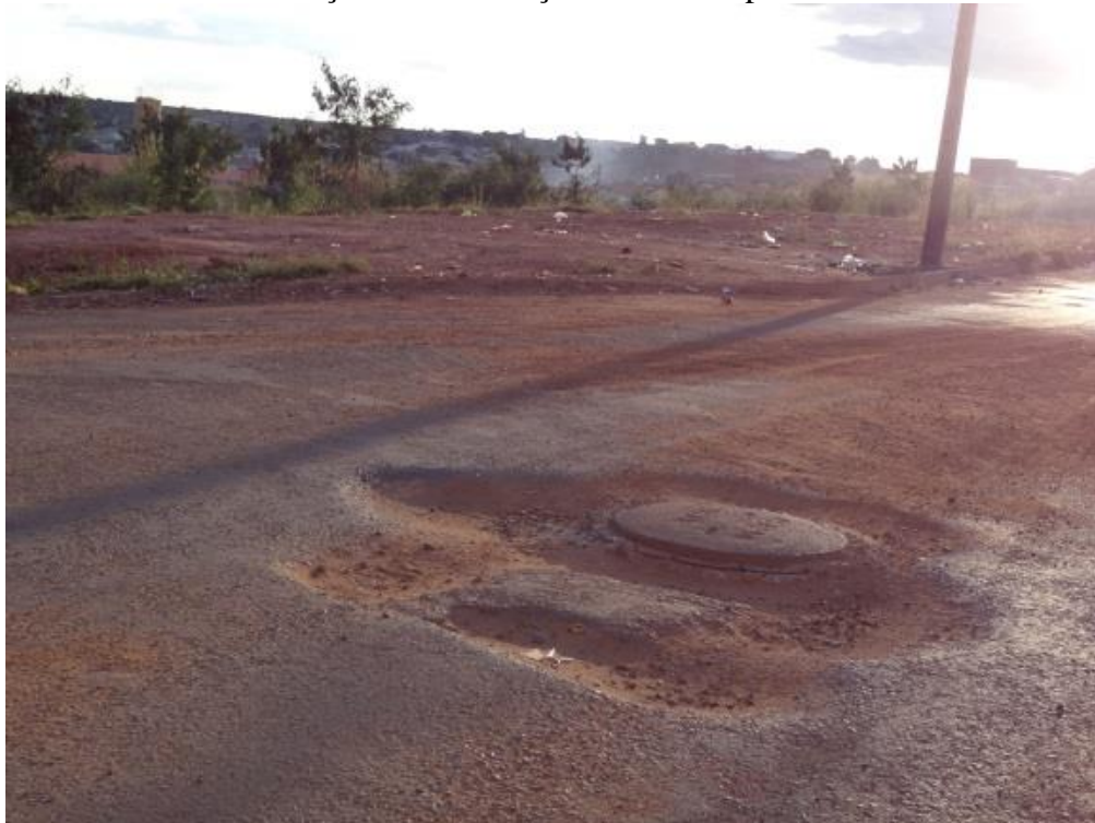
Ilustração 20 – Condições asfálticas precárias
