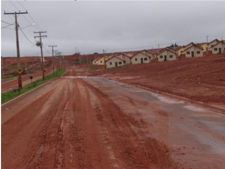
Ilustração 30 – Muita quantidade de terra e barro na avenida de acesso
