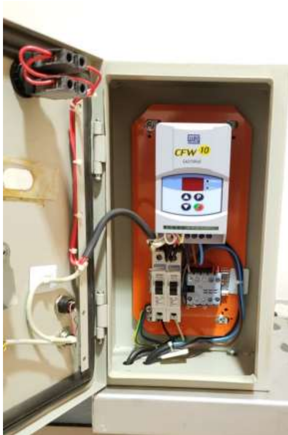
Figura 3.8 - Painel de comando
