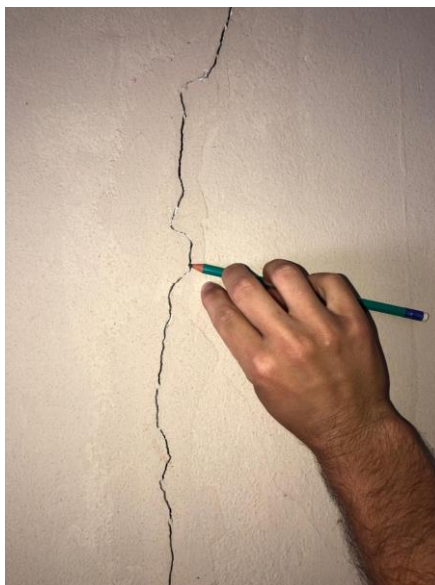
Figura 13 - Patologia 4. Lápís como referência de tamanho da abertura vertical
