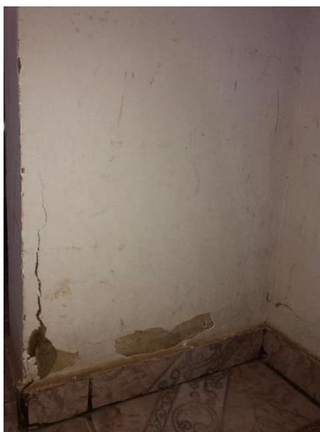
Figura 12 - Patologia 3: Abertura na vertical
