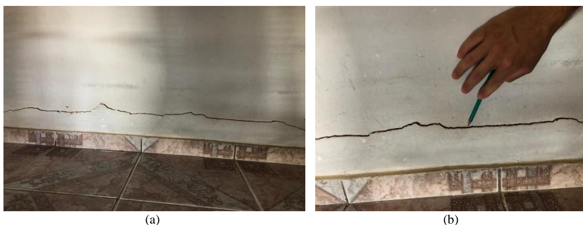
Figura 10 - Patologia 1. Abertura na horizontal (a); Lápis como referência de tamanho (b).
