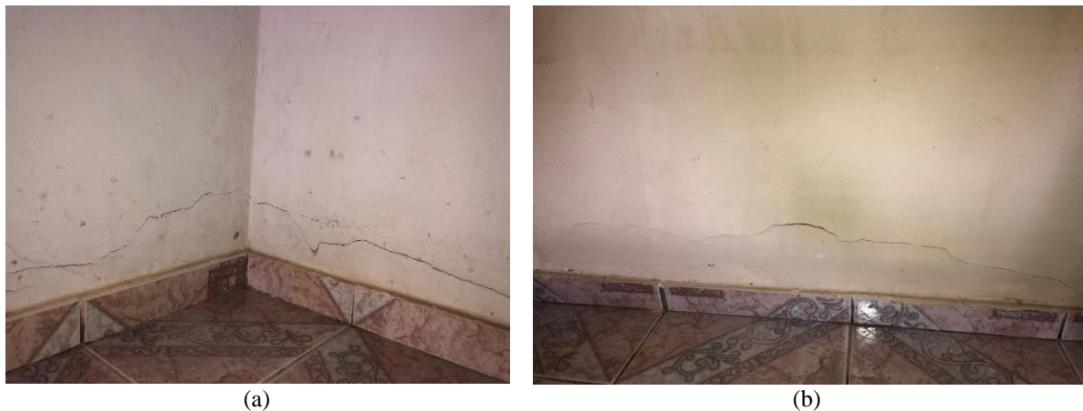
Figura 11- Patologia 2. Abertura na horizontal (a); Lápís como referência de tamanho (b).
