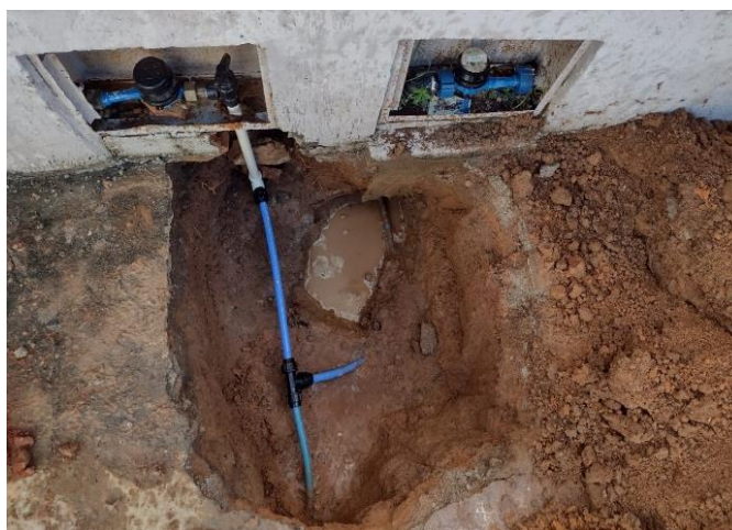
Figura 11 – Vazamento ocorrendo em uma derivação.
