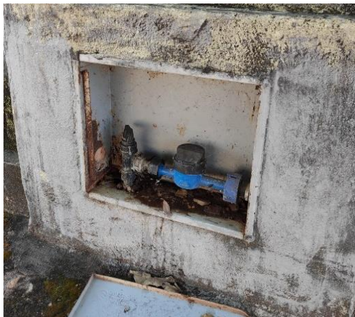
Figura 10 – Vazamento ocorrendo em cavalete.
