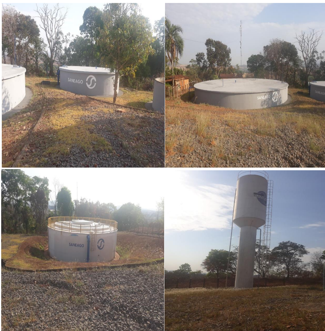
Figura 6 - Reservatórios de água tratada distribuídos pela cidade.
