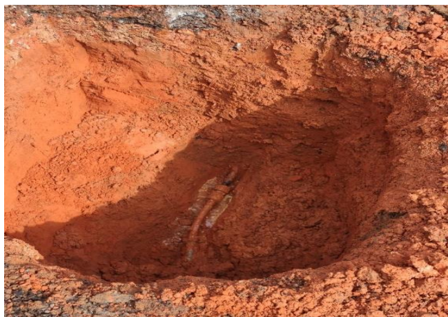
Figura 13 – Ramal após o vazamento ter sido sanado.
