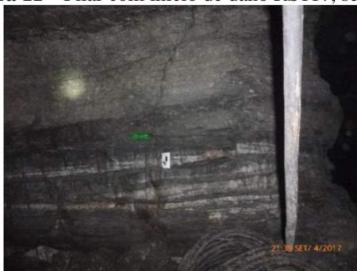
Figura 11 – Pilar com início de dano RS117, set 2017
