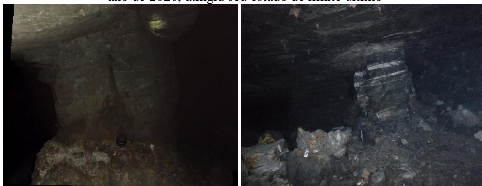
Figura 20 – Pilar na interseção de galerias no ano de 2017 já apresentando danos. O mesmo pilar no ano de 2020, atingiu seu estado de limite ultimo
