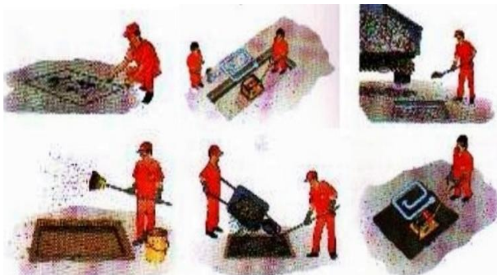
Figura 8 - Processo de recuperação de panelas ou buracos.
