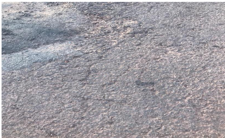
Figura 5 - Fissuras avenida das Rosas em Rubiataba-Go
