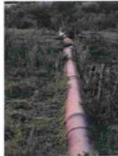
FOTO 03 - TUBULAÇÃO DESALINHADA, NO TRECHO DO BREJO
