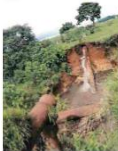
FOTO 02 - TUBULAÇÃO NA TRAVESSIA DO CÓRREGO, APÓS O ROMPIMENTO
