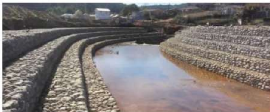
Figura 09: Barragem de Gabião
