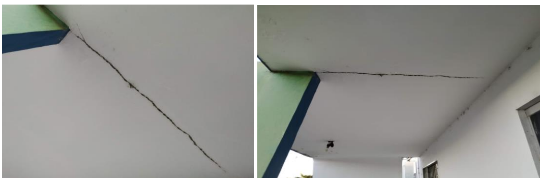
Figura 19 – Fissuras em laje externa da antiga Prefeitura Municipal de Uruaçu
