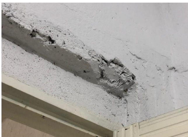
Figura 12 – Segregação do concreto da edificação residencial na Rua Primeiro de Maio - Uruaçu
