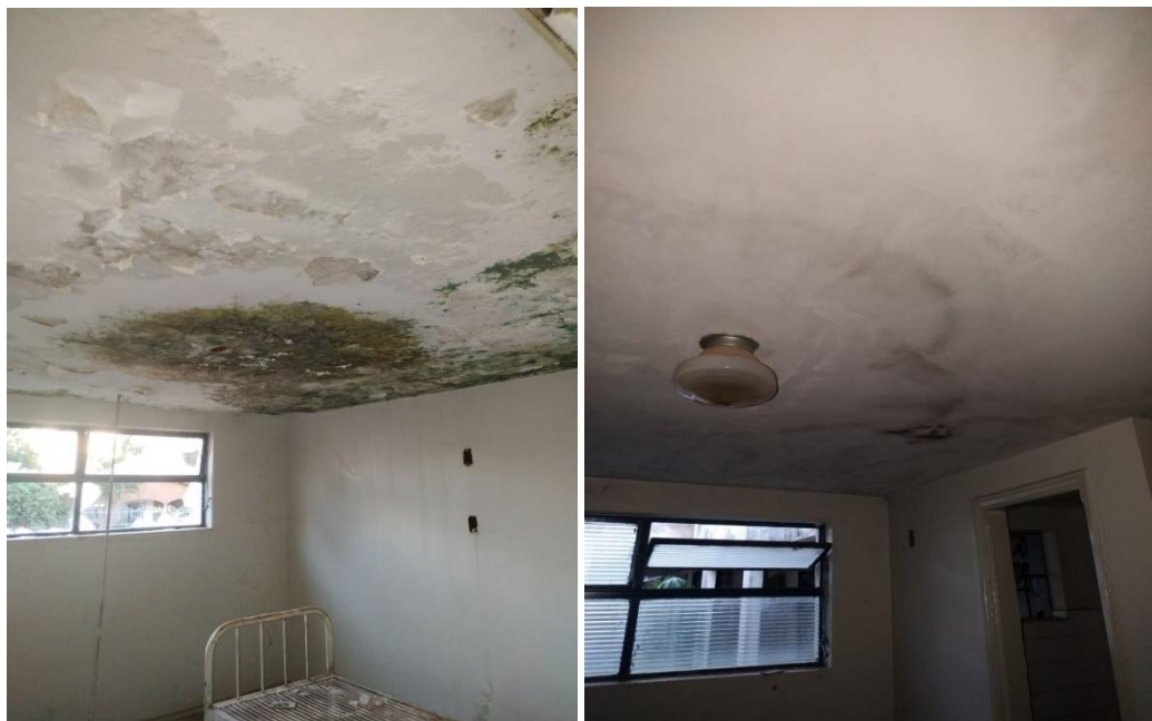
Figura 6 – Manifestação patológica por bolor no antigo hospital São Vicente – Uruaçu
