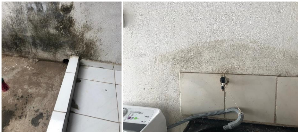
Figura 11 – Identificação de mofo em edificação residencial na Rua Primeiro de Maio - Uruaçu
