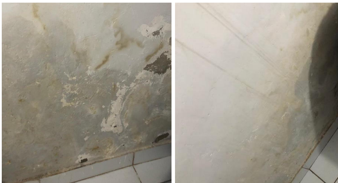
Figura 9 – Presença de infiltração em edificação residencial na Rua Primeiro de Maio – Uruaçu
