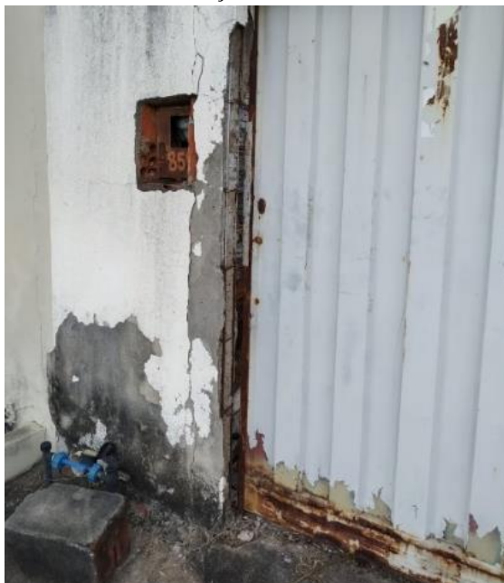
Figura 18 – Pilar com corrosão em edificação residencial na avenida Transbrasiliana – Uruaçu
