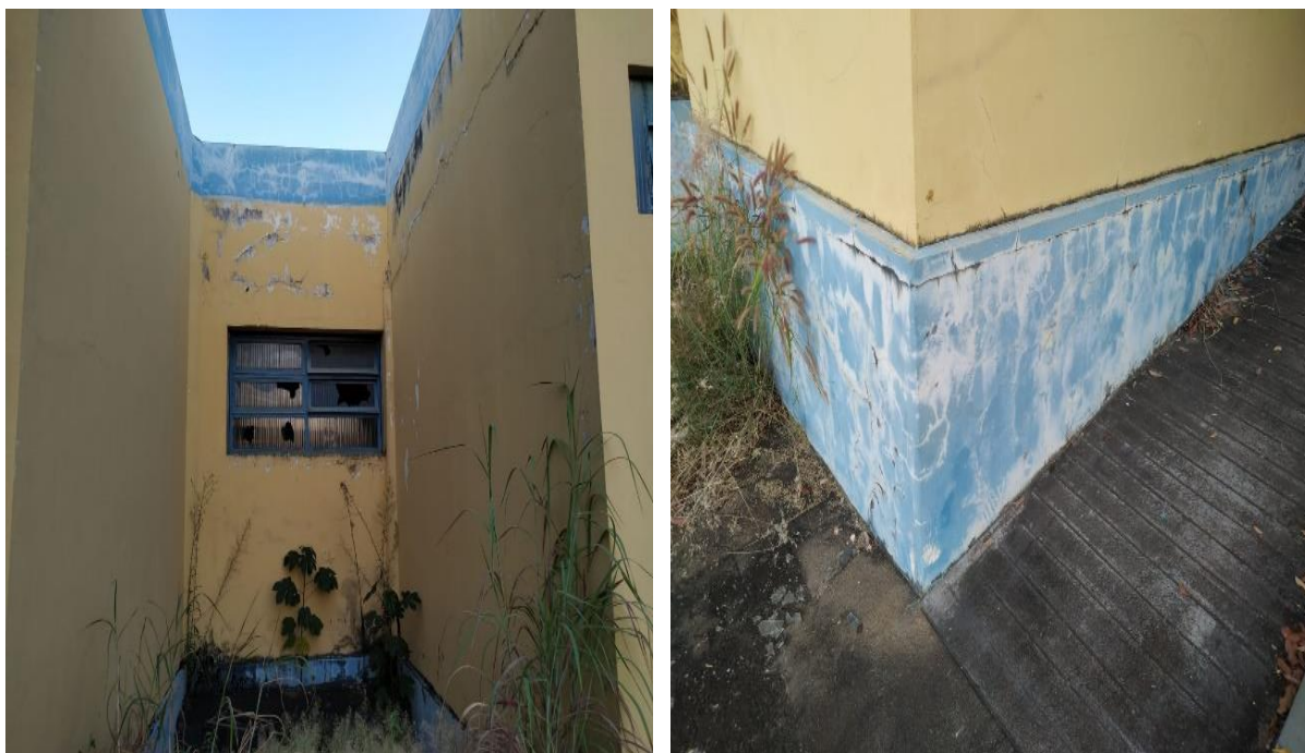
Figura 8 – Manifestação patológica por eflorescência no antigo hospital São Vicente – Uruaçu
