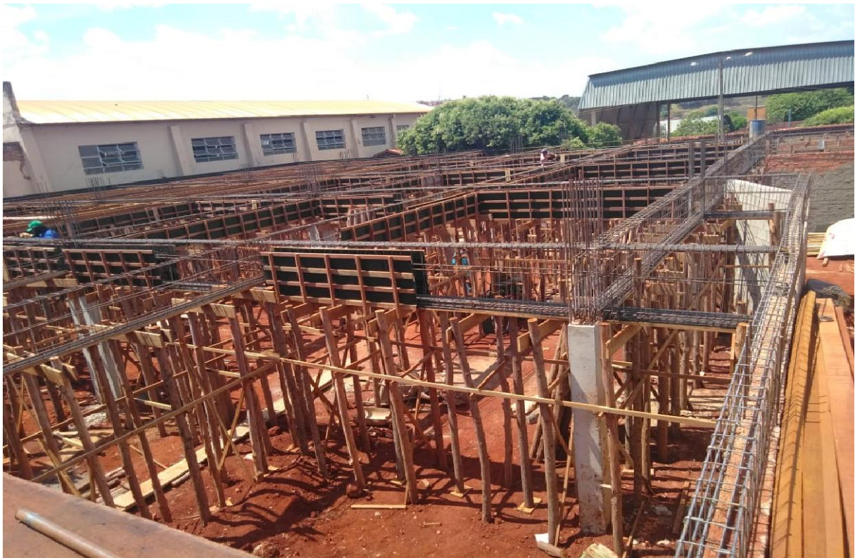
Foto 3: Fonte própria dos acadêmicos, obra em etapa colocação de montagens das formas da laje e armações de ferragens.
