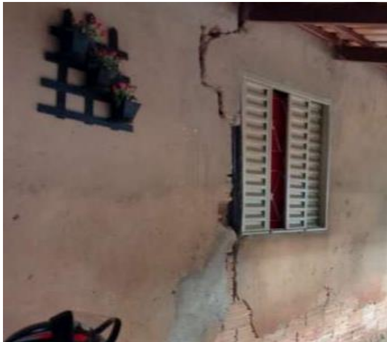
Figura 02: Fenda encontrada na alvenaria da edificação. Fonte: GERMANO, 2018.
